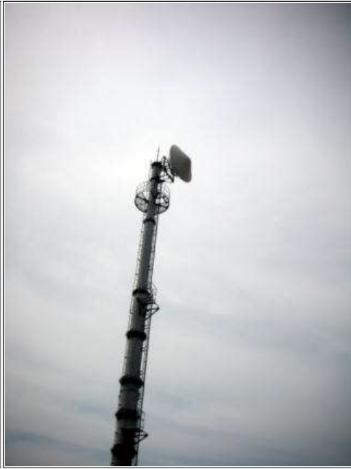
通信塔 通信用の電波塔
